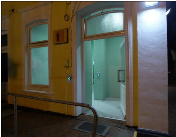
Abbildung 37: Die seit rund eineinhalb Jahren „wegen Sanierung“ verschlossenen Toiletten in Preetz stehen wieder zur Verfügung. Bis auf die Türöffner gibt es keine auffälligen Veränderungen.
