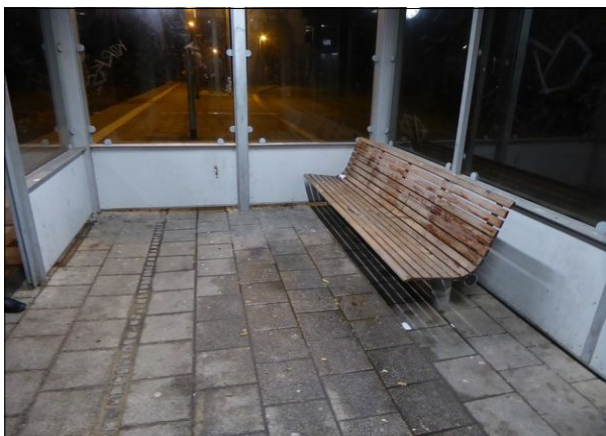
Abbildung 9: Die mittlerweile 13 Jahre alte Wartehalle in Rickling ist vor allem im geschützten Bereich undicht. Bei Regen laufen größere Wassermengen in den Wartebereich.
