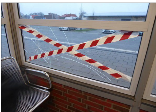
Abbildung 24: An der Wartehalle in Fehmarn-Burg wurde eine Scheibe mutwillig beschädigt.
