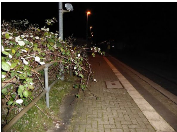
Abbildung 6: Auf den Bahnsteig an Gleis 2 in Herzhorn ragen stellenweise Brombeersträucher. In Kremperheide, Wilster, Burg (Dithm) und Pönitz ragten ebenfalls Pflanzen mehr als einen halben Meter auf die Bahnsteige.
