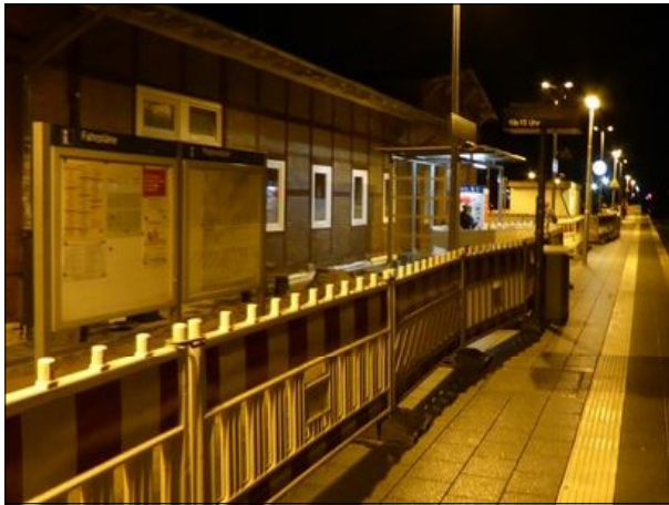
Abbildung 31: Der Infopunkt in Mölln befand sich hinter der Baustellenabspernung. Die Aushänge waren auch auf der Vorderseite („Fahrpläne“ und „Regionalplan“) nicht nennenswert lesbar.
