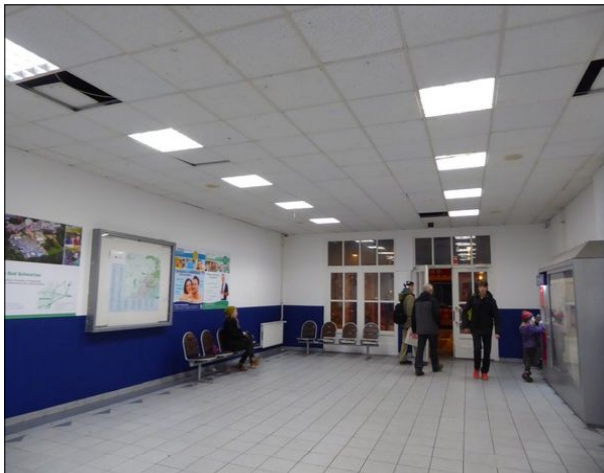
Abbildung 35: Auch in Bad Schwartau wurde der längst fällige Neuanstrich der Wände im Warterraum realisiert. Nur die losen Deckenplatten und verschmutzte Lampen trüben das Bild noch.
