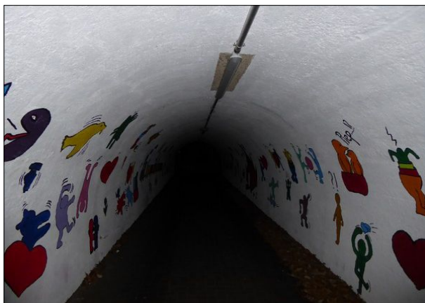
Abbildung 48: Die im Frühjahr 2015 erneuerte Tunnelbeleuchtung in Burg (Dithm) war defekt. Dies stellt einen großen Mangel dar.
