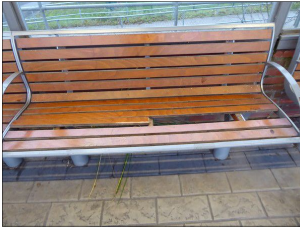
Abbildung 10: In der Wartehalle in Horst war an einer Bank eine Latte beschädigt.
