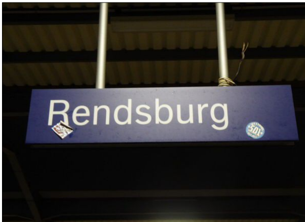
Abbildung 20: Das nicht angeschlossene Stromkabel ist der Grund für die nicht funktionierende Beleuchtung dieses Schildes. Warum die Aufkleber seit dem Sommer nicht entfernt wurden bleibt dagegen unklar.
