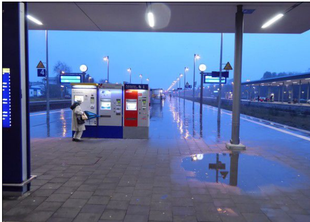
Abbildung 55: Durch eine Absackung des Pflasters bildet sich unter dem Dach in Heide eine größere Pfütze.
