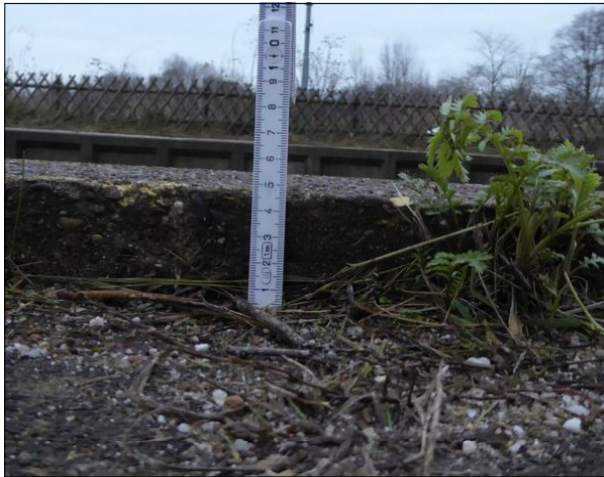
Abbildung 5: In Friedrichstadt finden sich bereichsweise größere Absackungen mit Stufenbildung von mehreren Zentimetern Höhe an den Bahnsteigkanten.
