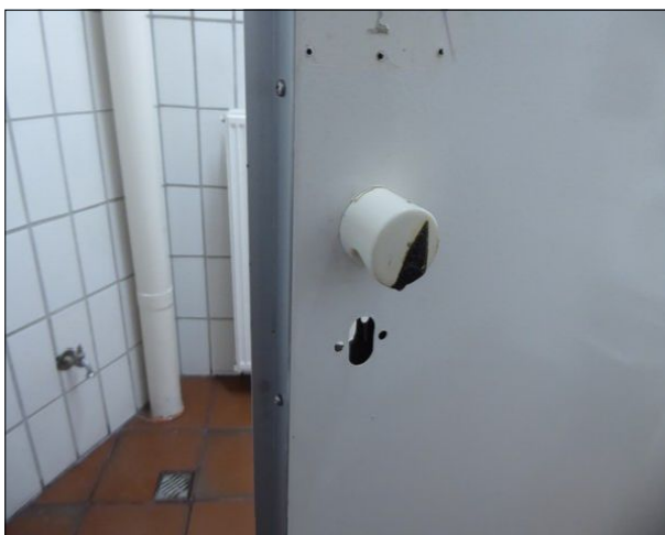
Abbildung 39: Die Herrentoilette in Owschlag war aufgrund des fehlenden Schlosses nicht abschließbar.
