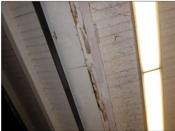
Abbildung 8: Das Bahnsteigdach in Preetz ist stellenweise undicht. Neben den Lackschäden an den feuchten Stellen fallen Verschmutzungen auf ganzer Länge des Daches auf.
