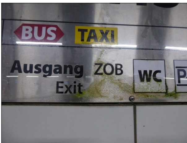
Abbildung 30: Auf den Schildern an den Bahnsteigen in Henstedt-Ulzburg haben sich durch Feuchtigkeit Algen unter den Schutzabdeckungen gebildet.
