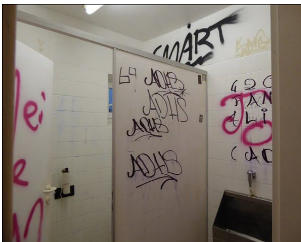
Abbildung 42: Nicht unbedingt die Schmierereien sondern vor allem ein sehr übler Geruch machten das Herren-WC in Gettorf unbenutzbar.
