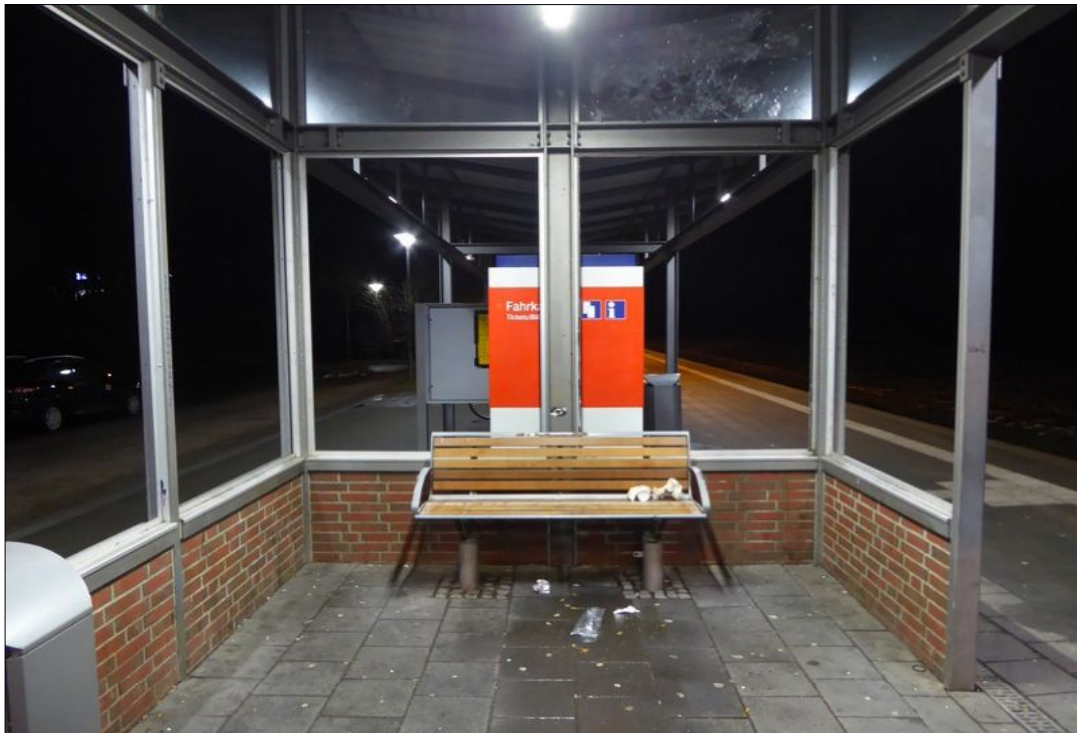
Lensahn: Haltepunkt an der Strecke Lübeck - Puttgarden. Alle großen Scheiben der Wartehalle fehlten. Zudem war diese undicht und verschmutzt.
