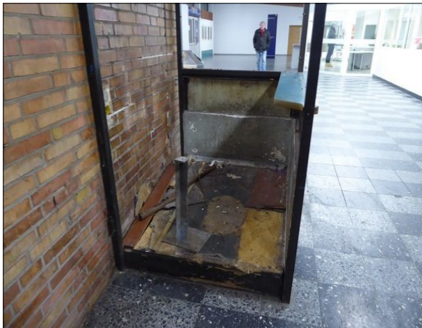
Abbildung 38: Dieser Einbau in der Bahnhofshalle von Elmshorn beeinträchtigt seit dem Sommer unverändert das Erscheinungsbild und stellt eine Unfallgefahr dar.
