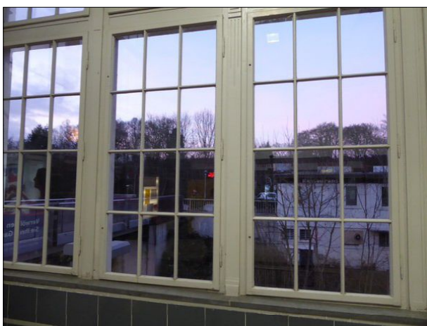
Abbildung 39: Die großen Fenster der Bahnhofshalle in Aumühle wurden seit Jahren erstmals außen gereinigt. Die kleineren Fenster oben müssten als nächstes folgen.
