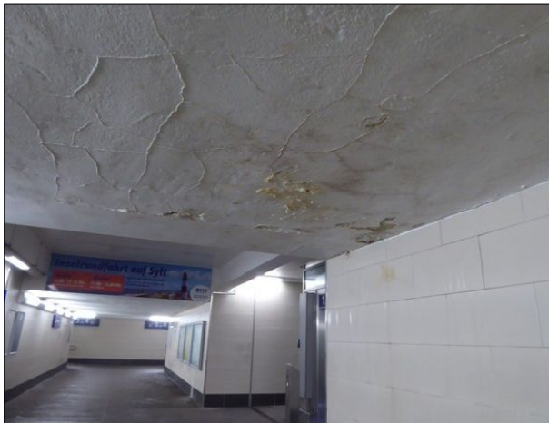
Abbildung 47: Deutlich zunehmende Tendenz weisen die sichtbaren Feuchtigkeitsschäden an der Tunneldecke des DB Bahnhofs in Niebüll auf.
