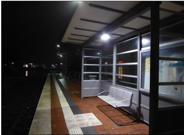
Abbildung 10: Nachdem die Beleuchtung des Unterstands in Hademarschen jahrelang nie an den Strom angeschlossen wurde, ist jetzt eine neue mit Solarzelle installiert worden. Diese funktioniert.
