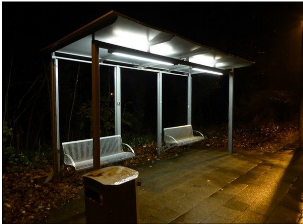
Abbildung 25: Alle Scheiben des Unterstands an Gleis 1 in Einfeld fehlten. An Gleis 2 fehlten zwei Scheiben.
