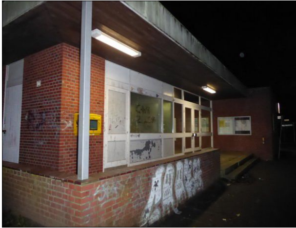
Abbildung 37: Das Erscheinungsbild des Bahnhofsgebäudes in Tönning ist unakzeptabel. Innen sieht der Wartebereich deutlich besser aus.
