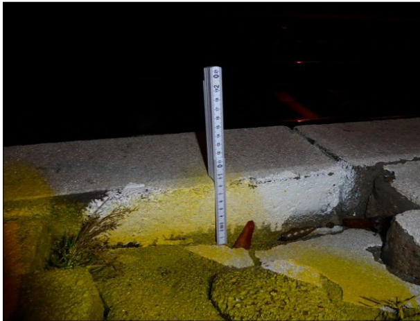
Abbildung 4: Stellenweise waren in Flintbek Pflastersteine des Bahnsteigs an Gleis 2 abgesackt. Es entstanden vor der Bahnsteigkante bis zu 9 cm hohe Stufen.
