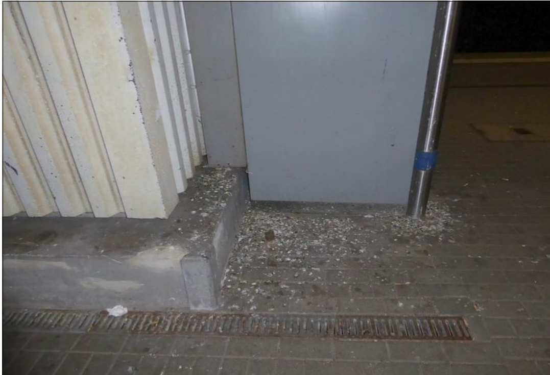
Neumünster: Bahnhof an der Strecke Hamburg - Kiel/Neumünster. In allen Bereichen gab es Verschmutzungen durch Taubenkot. Auf dem Bahnsteig an den Gleisen 5/6 waren diese besonders umfangreich.
