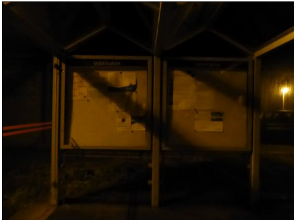
Abbildung 34: Durch die defekte Vitrinensbeleuchtung sind die Aushänge in Beldorf seit neun Jahren (!) bei Dunkelheit nicht lesbar.
