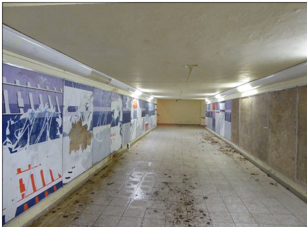
Abbildung 52: Mit Feuchtigkeitsschäden, fehlenden, beschädigten und bekritzelten Tapeten sowie Laub auf dem Fußboden macht die Unterführung in Bad Schwartau einen vernachlässigten Eindruck.
