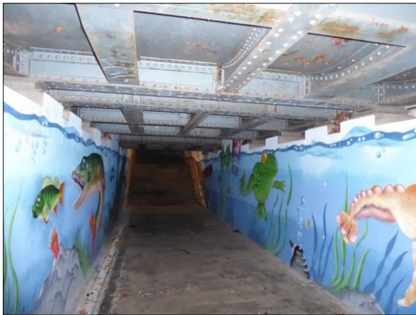
Abbildung 46: Durch die Gestaltung der Wände des Tunnels in Bad Malente-Gremsmühlen wurde das Erscheinungsbild verbessert. Die Gleiströge sind jedoch weiterhin angerostet und undicht.
