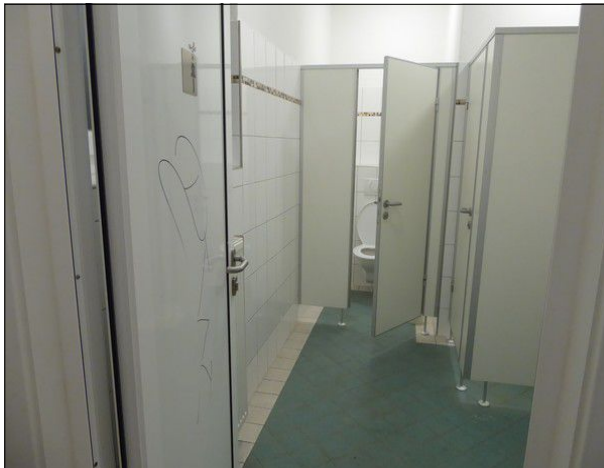
Abbildung 40: Die für rund eineinhalb Jahre aufgrund wiederholten Vandalismus gesperrten Toiletten in Lauenburg sind wieder geöffnet.
