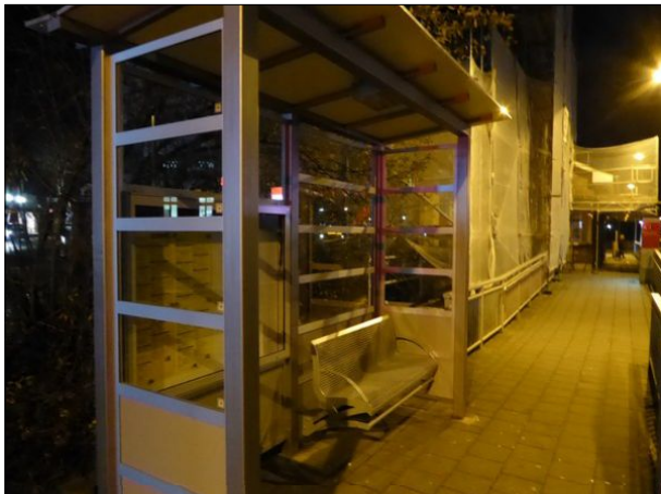
Abbildung 11: Weder das Licht im neuen Unterstand noch die Vitriinenbeleuchtung funktionierten in Sörup.
