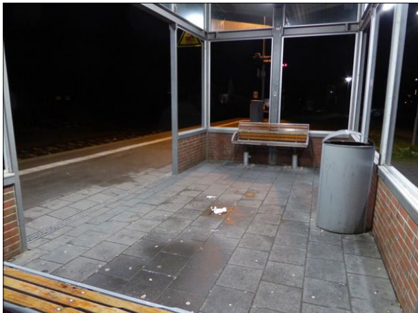
Abbildung 8: In der Wartehalle von Lensahn fehlen nicht nur alle großen Scheiben. Einiges Wasser tropft durch das Dach in den Wartebereich.
